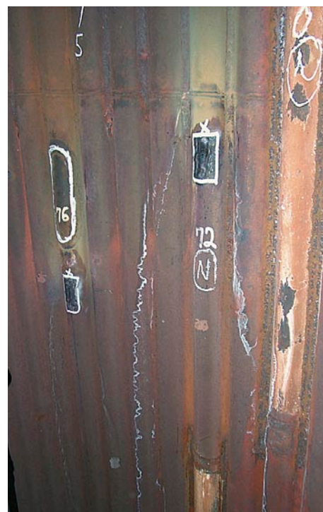
Рис. 6. Ремонтные заплатки и течи с булавочную головку
